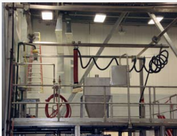
5. Rostfri säcklyftare installerad i en komplett rostfri anläggning i en juice-tillverkningsprocess.
